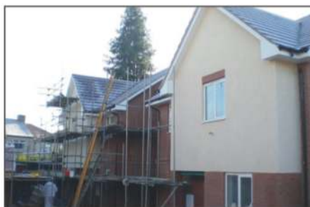
budynek pod Londynem, tynk cienkowarstwowy ułożony bez docieplenia na ścianie z bloczków
